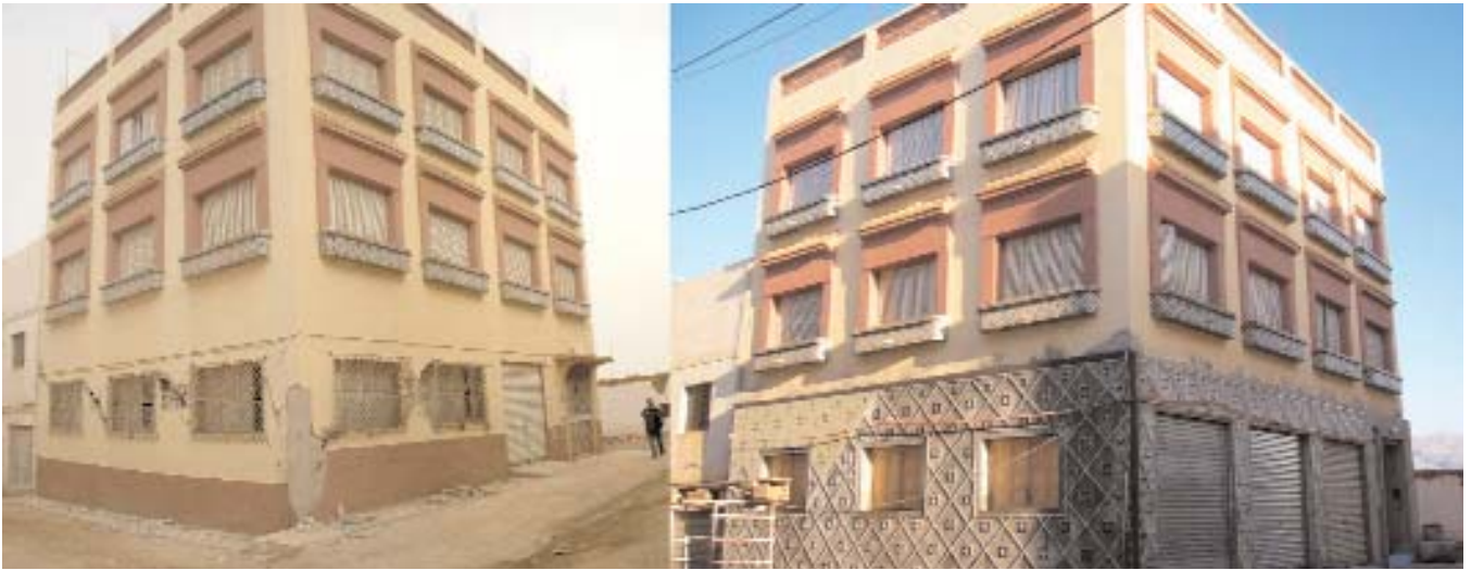
Figures 5 et 6. Construction montrant des piliers endommagés, réparée avec un mur en béton qui enveloppe tout le rez-de-chaussée. /PATRICK MURPHY
